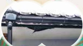
軒天 ● 軒の破損 ● 塗装の浮き
