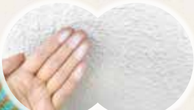
外壁 ● チョーキング (壁をこすると白くなる)
